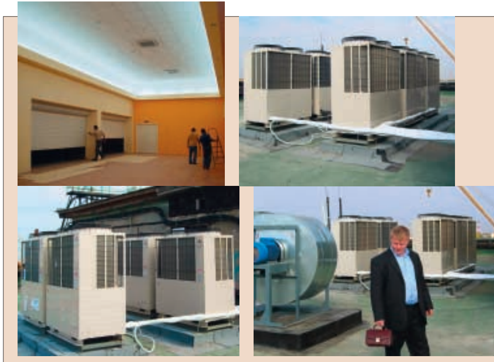
■ KX4 завоевывает российский рынок. В Нижнем Новгороде ООО «Вентсервис» оснащает торгово-офисный центр «Орбита». Устанавливается 60 наружных блоков мощностью 30–45 кВт
